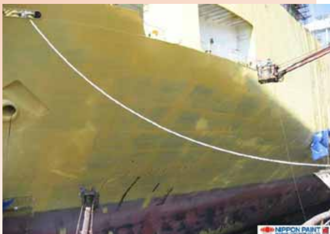
Obrázek: Obnova nátěrového systému trupu lodi. Zřetelně je možno rozlišit plochy, na kterých bylo dosaženo korektní WFT / DFT základního nátěru NOA 10 M, typ 225.
