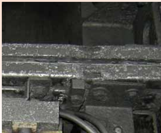
Obrázek 7 - Příklad korozního napadení
