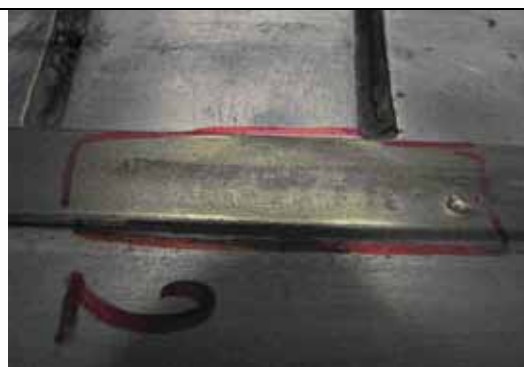
Obr. 4.4 Opotřebení v místě 2
