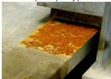
Oprýskaný povlak žárového zinku pod pojezdovým kolem
