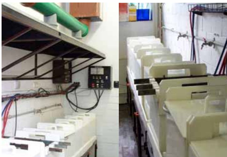
Obr.1 Nová galvanická linka s centrálním řízením a výkonným odsáváním.
