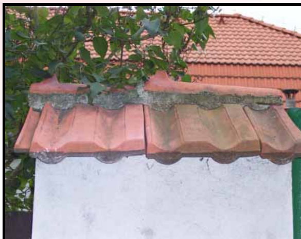
obr.5 - Sloupek a krytina vlevo je opatřen funkčním nátěrem FN1 (foto po 12 měsících).
