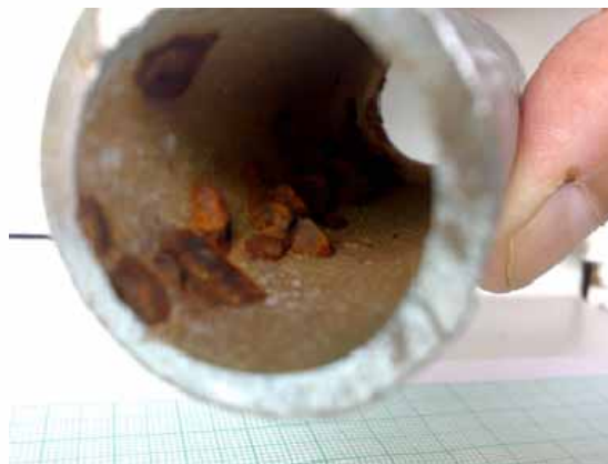
Obr. 6 Bodová koroze na vnitřní stěně žárově pozinkovaného ocelového potrubí Ø3/4 palce.
