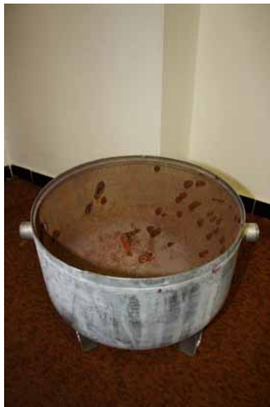
Obr. 7 Výskyt bodového korozního poškození na vnitřní žárově pozinkované stěně zásobníku TUV.
