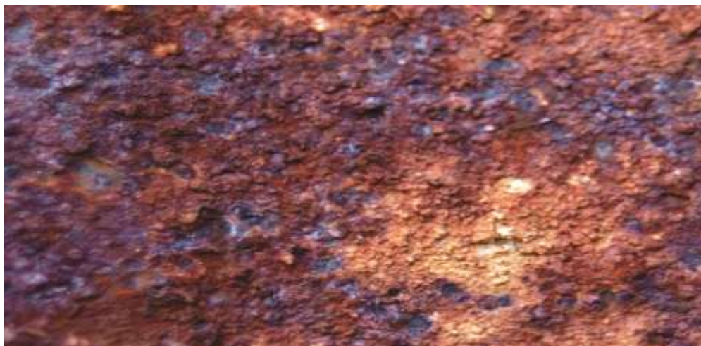
Obrázek č. 13 Souvislá koroze v povrchu oceli
