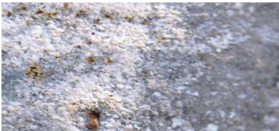
Obrázek č. 8 Koroze ve vrstvě η (éta), souvislé pokrytí ZnCO 3
