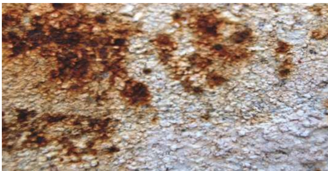
Obrázek č. 11 Koroze pronikající do vrstvy \gamma (gamma)
