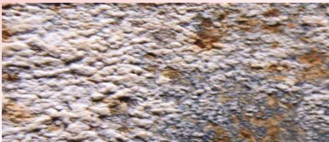
Obrázek č. 9 Koroze pronikající do vrstvy \zeta (zeta)
