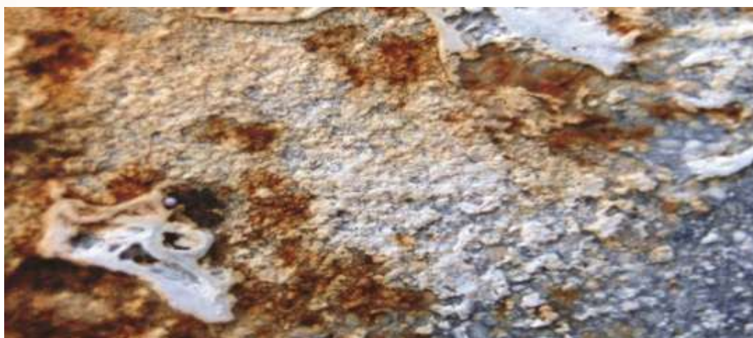
Obrázek č. 10 Koroze pronikající do vrstvy \delta (delta)
