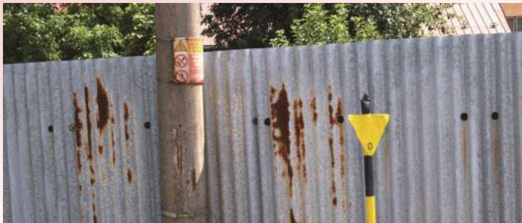
Obrázek č. 4 Vliv vegetace na korozi pozinkované oceli
