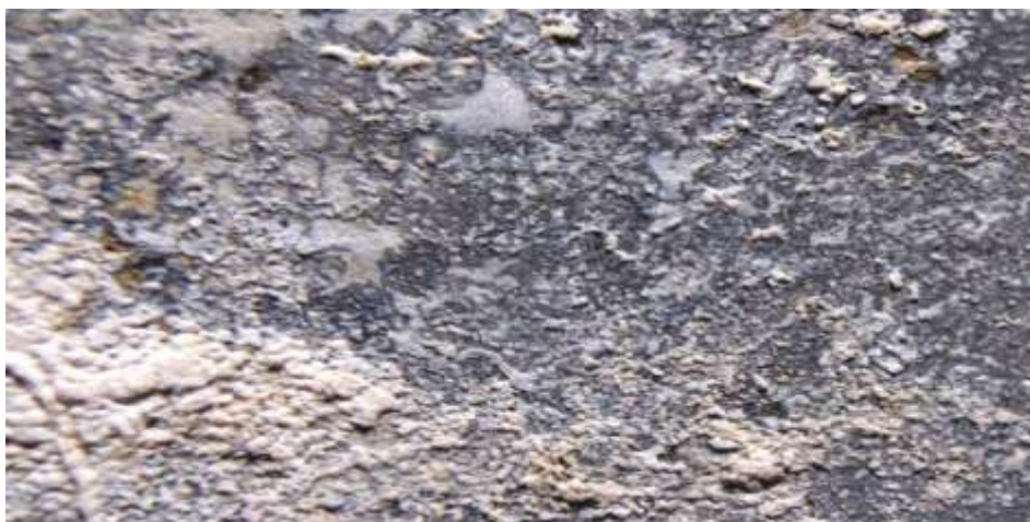
Obrázek č. 7 Koroze ve vrstvě η (éta) s izolovanými shluky ZnCO 3
