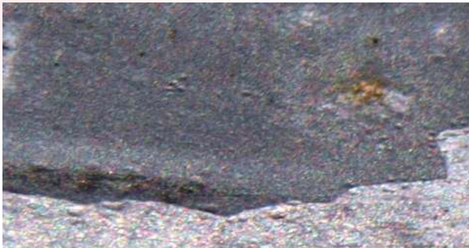
Obrázek č. 6 Vyvinutý povrch zinku s prvními počátky hlubší koroze
