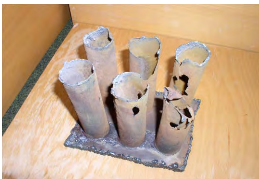
Obr. 1. Poškození trubek výměníku vzduchu LUWO z nelegovaných ocelí bez protikorozi ochrany na teplárně Hodonín
