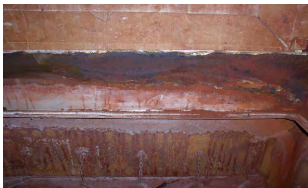
Obr. 2. Poškození místa výstupu spalin tkaninových filtrů na spalovně Bratislava vyrobené z nelegovaných ocelí
