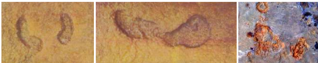
Obr. 2 Mělký korozní bod jako výsledek působení mikrobiální koroze na dně zásobníku obsahujícího surovou ropu po 18 letech služby
