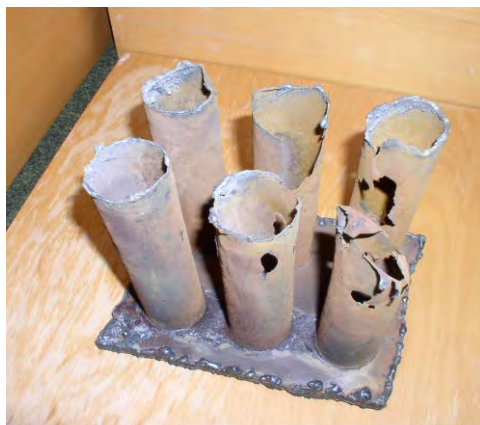
Obr. 6 Poškození výměníku vzduchu z uhlí- kové oceli ve spalinách pod rosným bodem HCl
