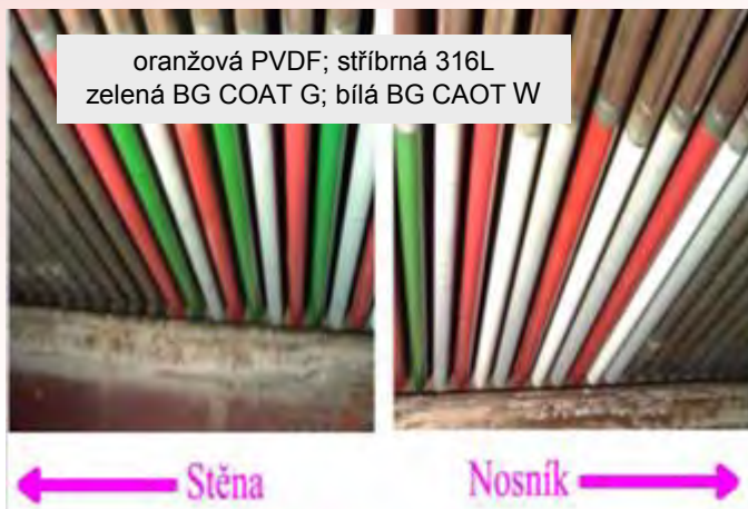
Obr. 9 ELE Kladno-ohřívák vzduchu (LUVO)
