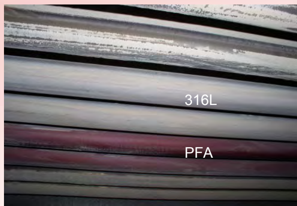
Obr. 8 ELE Hodonín - stav trubek po 7 000 h provozu Ohřívák vzduchu (LUVO)
