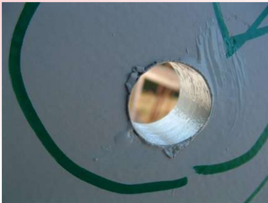
Obr.4 Neodstraněný otřep po vyvrtání díry – chybná přejímka před započatím povrchové úpravy.
