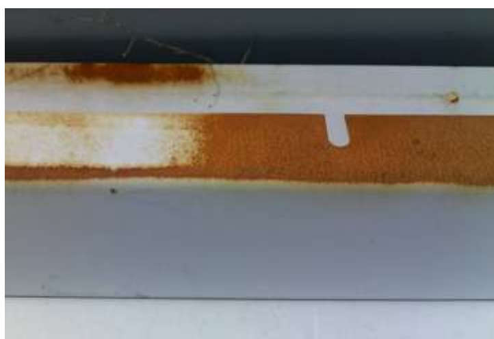
Obr.2 Degradace dočasné ochrany základním nátěrem při nedodržení minimální předepsané tloušťky vrstvy 40 \mu m – stav po 3 měsících vystavení na venkovní atmosféře
