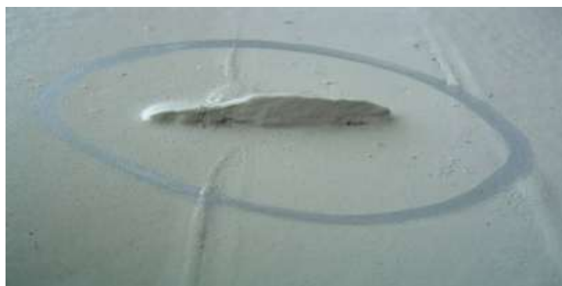
Obr.3 Nedůsledně odstraněná část svaru po odstranění manipulačního oka při montáži OK – chybná přejímka před započítím povrchové úpravy.
