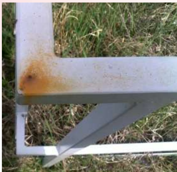
Obr.1 Netěsný svar v rohu madla zábradlí – stav po 6 měsících vystavení na venkovní atmosféře
