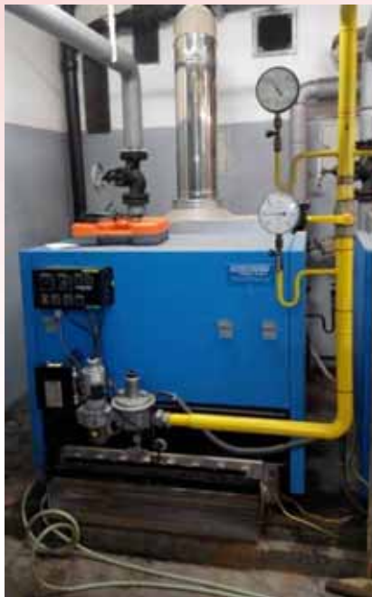
Obr. 2: Fotografie čištěného kotle (objem kotle 121 l, provozní parametry – tlak max. 6 barů, teplota max. 120 °C).
