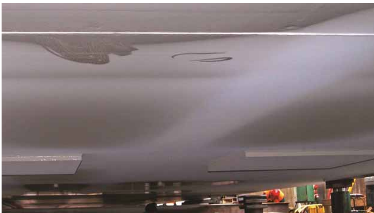
Obr. 3: Povrch spodní pásnice ocelové konstrukce mostu, se zřetelnou jinovatkou
