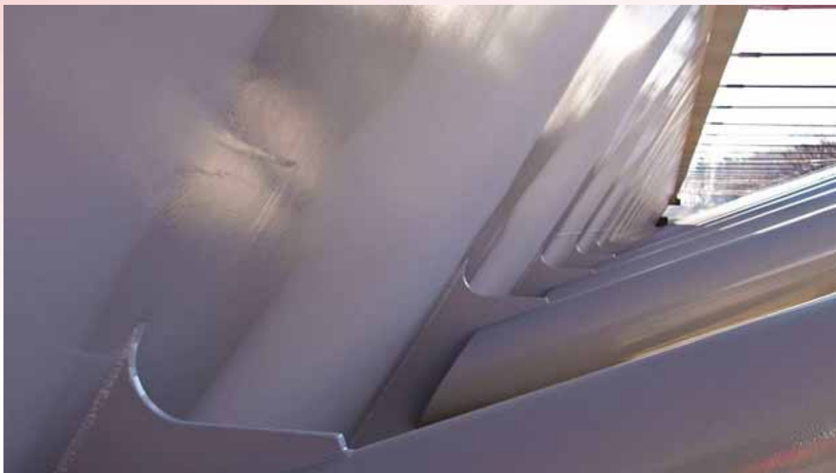
Obr. 2: Povrch stěny ocelové konstrukce mostu, s patrným orosením.
