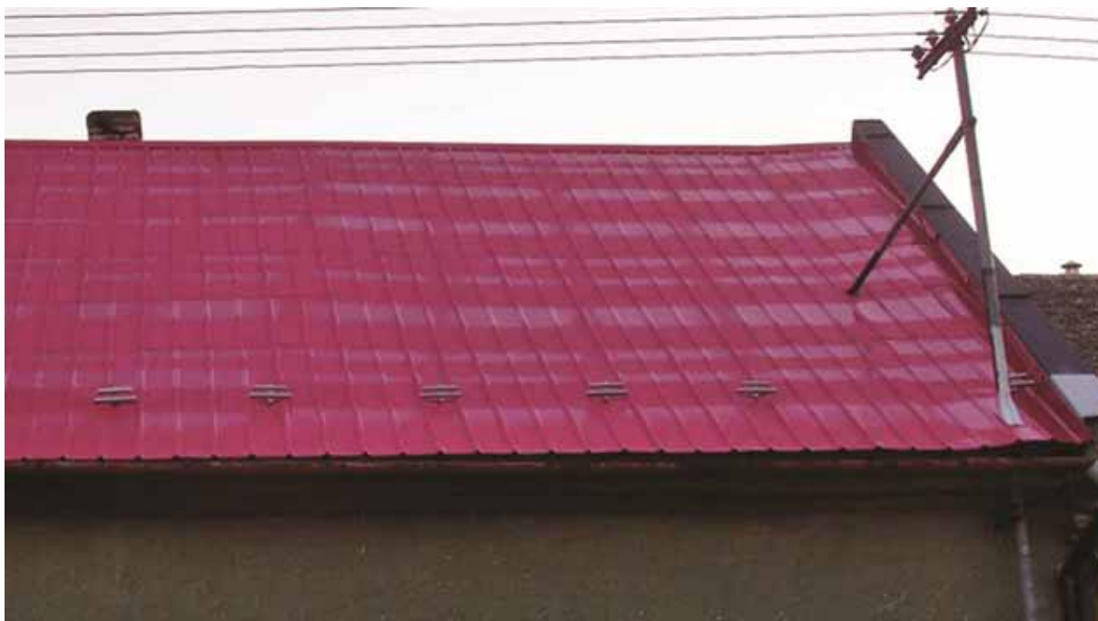
Obr. 5: Střecha rodinného domku s degradujícím PUR nátěrem
