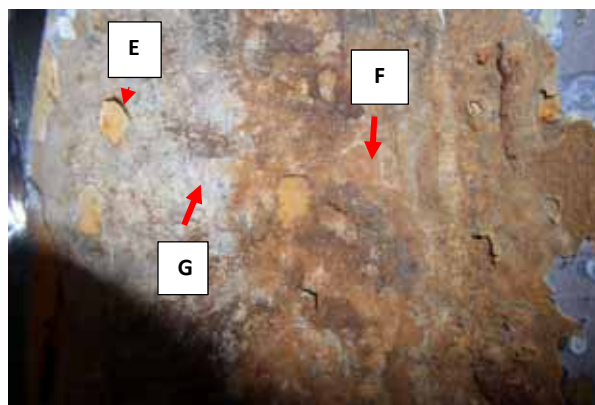
Obr. 19: Korozní produkty na vnitřní straně trubky
