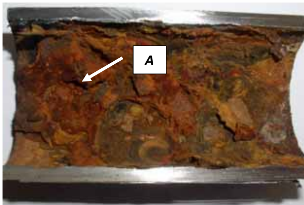
Obr. 4: Korozní zplodiny na vnitřním povrchu trubky v teplé vodě
