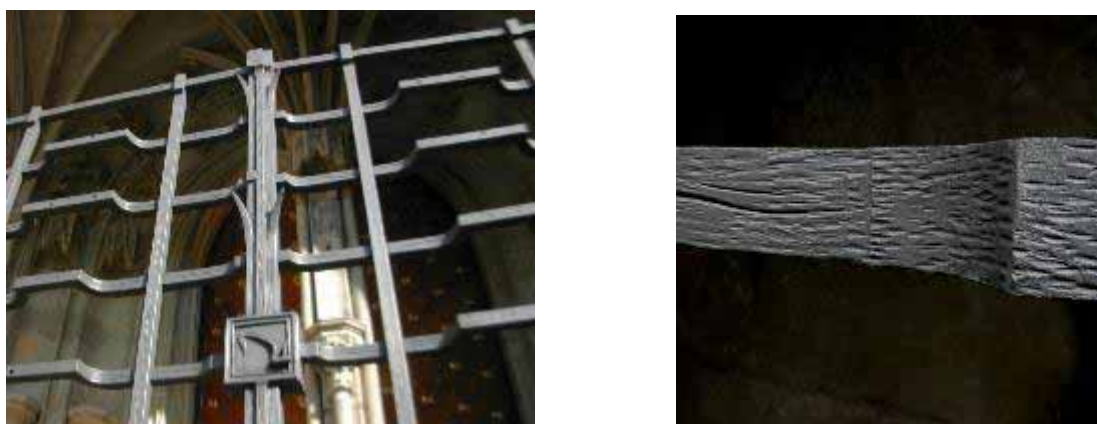
Obr. 4: Mříže před bočním vchodem do chrámu sv. Víta opatřené kompletním organicky modifikovaným zinksilikátovým nátěrovým systémem – základní vrstva organicky modifikovaný ZSN s vysokým obsahem Zn / vrchní nátěr v odstínu antracitovém, nanášení štětcem, povrch dodatečně rozleštěn, úprava podkladu tryskání ostrohranným abrazivem, vpravo viz detail natřené konstrukce.
