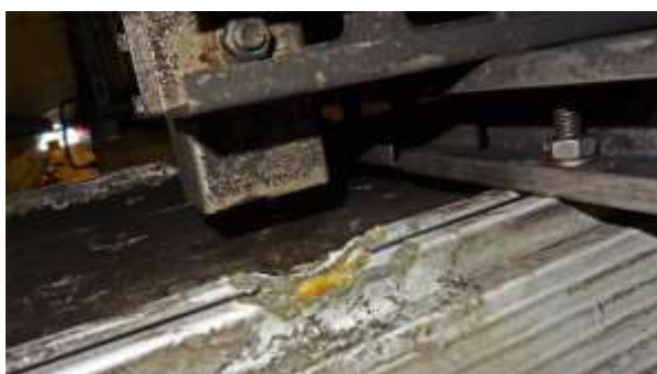
Obr. 7 Dálniční tunel Valík koroze skříně osvětlovacího tělesa
