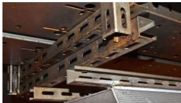
Obr. 6: Dálniční tunel Klimkovice koroze energolávky a závěsů
