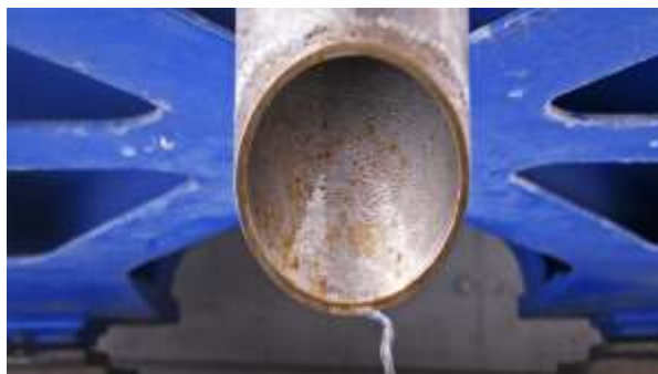
Obr. 5: Lávkva ve Frýdku - Místku trubice odvodnění – vrstva solí a koroze
