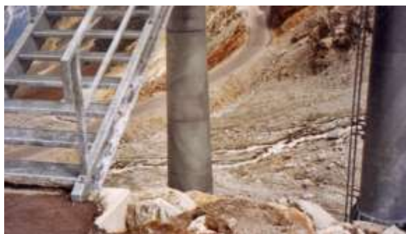
Obr. 4: Lyžařské centrum Rettenbach koroze konstrukcí lanovky
