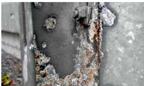
Obr. 3: Silniční obchvat Jablunkova koroze pozinkovaných svodidel
