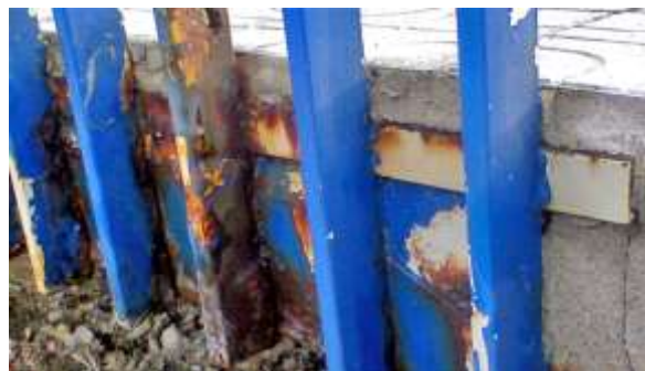
Obr. 2: Lávka ve Frýdku - Místku koroze zábradlí na přístupové rampě
