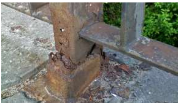
Obr. 1: Most ve Frýdku - Místku úplná destrukce sloupku zábradlí nad patkou
