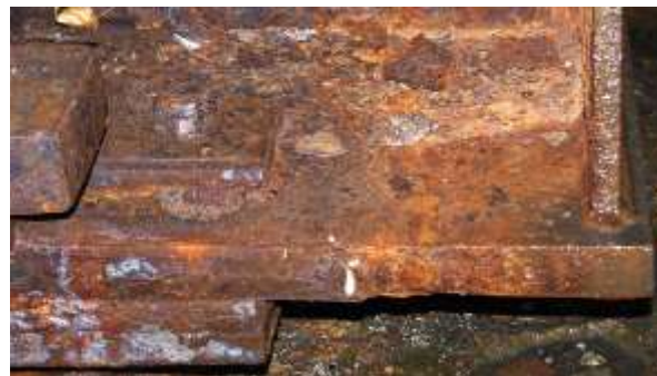
Obr. 10 Silniční most Frýdek - Místek Těžká koroze hlavního nosníku nad podpěrou
