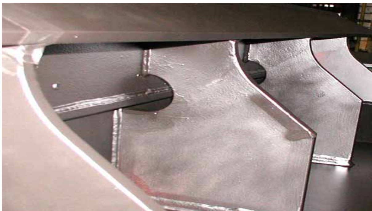
Obr. 2: Ocelový dílec s povrchem „vyhlazeným“ nesprávným tryskáním
