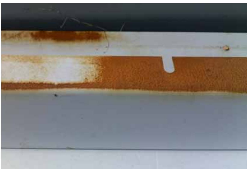
Obr. 2: Degradace dočasné ochrany základním nátěrem při nedodržení minimální předepsané tloušťky vrstvy 40\mu\text{m} – stav po 3 měsících vystavení na venkovní atmosféře
