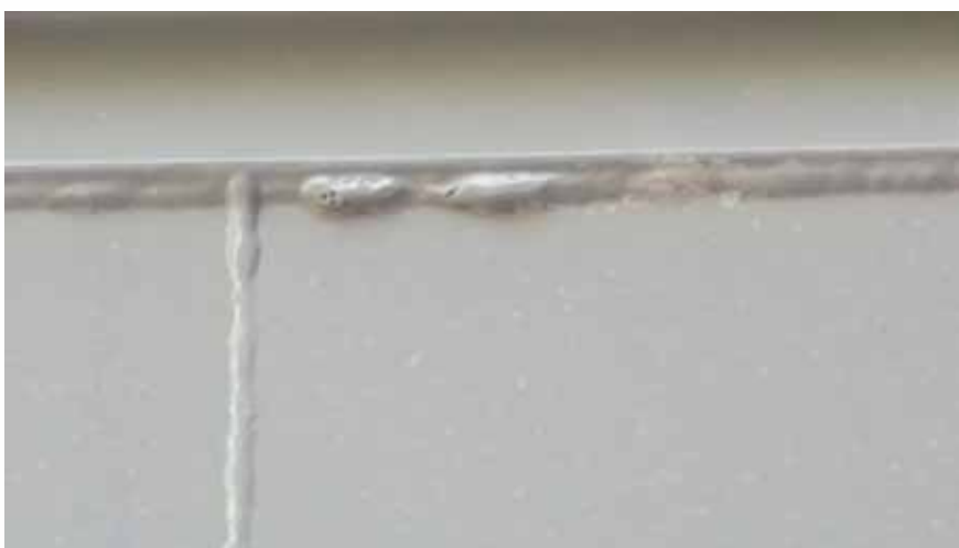
Obr. 5: Porézní část svarové housenky – chyba svařeče – nedůsledná přejímka před započítím povrchové úpravy.
