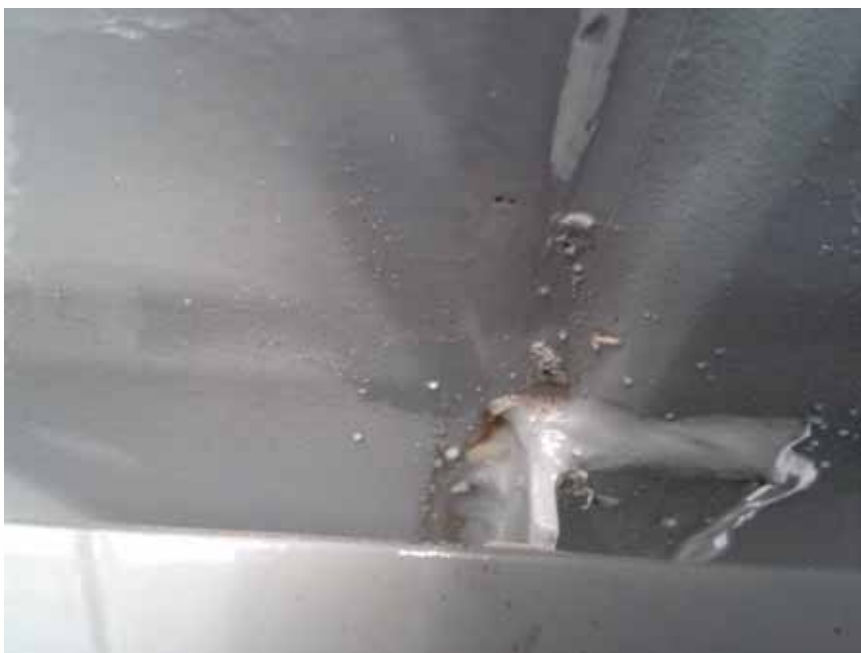
Obr. 4: Neodstraněný rozstřík svarového kovu – chybná přejímka před započítím povrchové úpravy.
