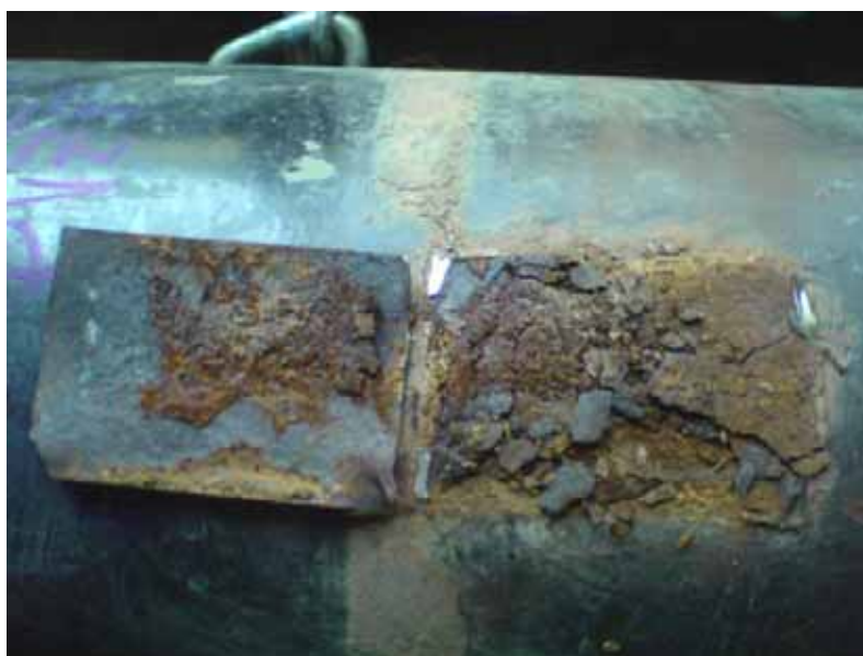
Obr. 2: Korozní zplodiny pod štítkem vzduchojemu
