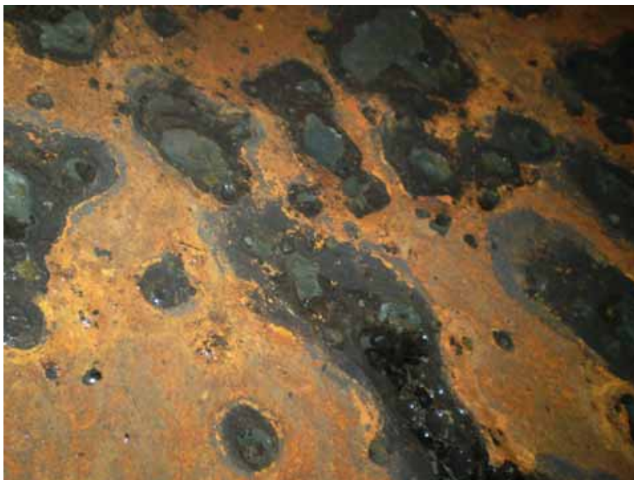
Obr. 1: Důlková koroze vnitřní stěny expandéru topné soustavy
