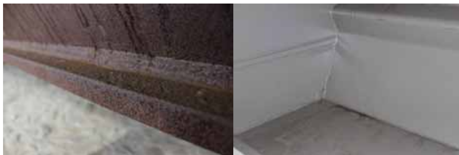
Obr. 6: Důsledek chybného řešení detailu svaru u komorové konstrukce (vlevo), ošetření vnitřních ploch komorové konstrukce nátěrovým systémem (vpravo)
