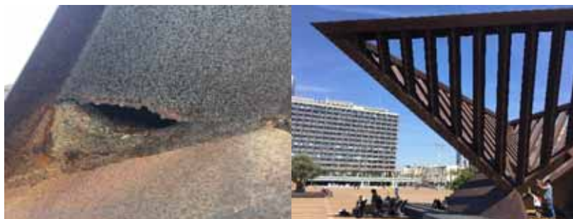
Obr. 8: Prokorodování monumentu z Cortenu v prostředí zvýšené vzdušné salinity (2 km od pobřeží)
