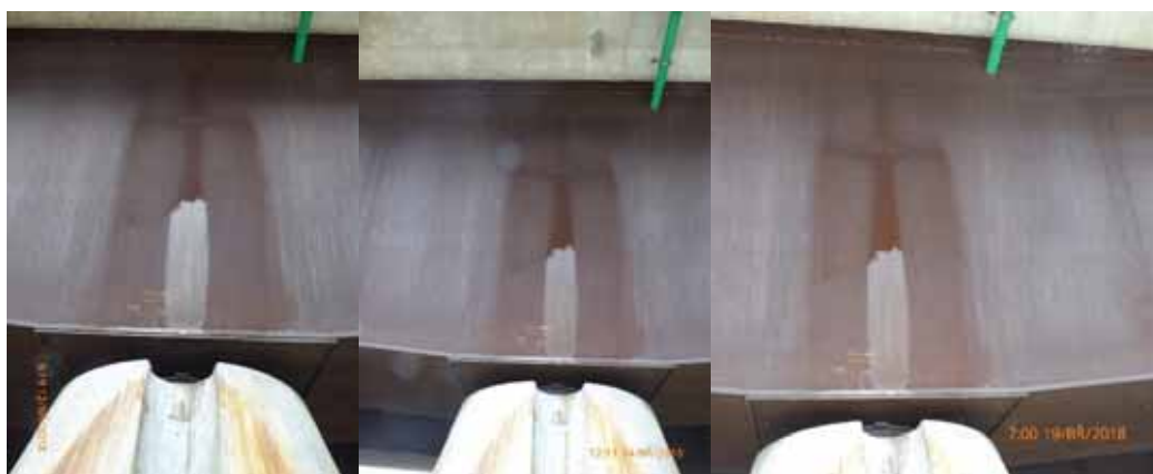
Obr. 3: Dlouhodobé ovlhčení mostní konstrukce vlivem tepelné kapacity díla (zleva 12.3., 14.3. a 19.3)
