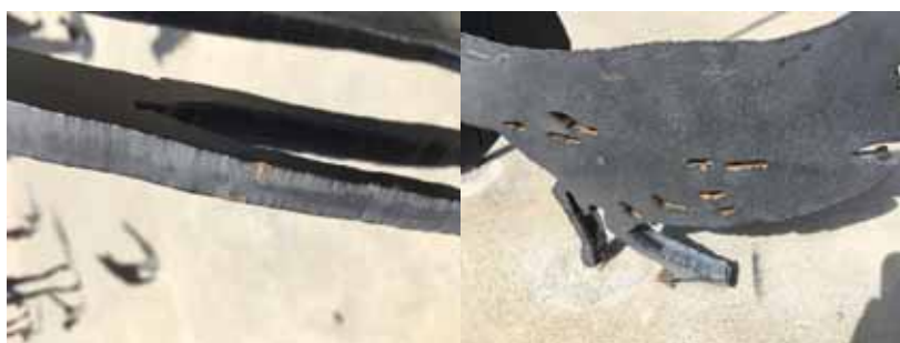
Obr. 7: Patinující ocel opatřená nátěrem – detail poškození povlaku (vlevo), objekt ani jeho okolí není postiženo stékáním rzi z důvodu funkční ochranné patiny v místě defektů (vpravo)
