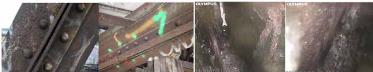
Obr. 5: Zvolené zkušební místo č. 1 – Zleva: Před a po tryskání, vpravo: po tryskání, fotografie pořízené pomocí průmyslového videoskopu IPLEX G Lite
