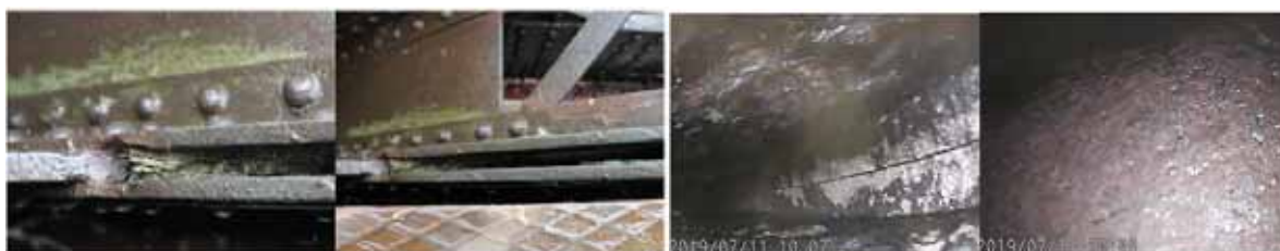
Obr. 5: Zvolené zkušební místo č. 1 – Zleva: Před a po tryskání, vpravo: po tryskání, fotografie pořízené pomocí průmyslového videoskopu IPLEX G Lite
