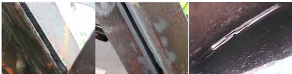
Obr. 7: Zvolené zkušební místo č.4 – Vlevo: tryskání ocelové konstrukce pomocí vodního paprsku, uprostřed: následné tryskání pomocí křemičitého písku (po předúpravě štěrbin), vpravo: kompletně průchozí štěrbina
