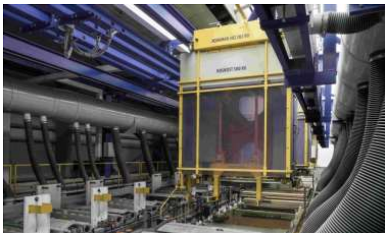
Obr. 2: Dopravník s odkapovou vaničkou a odsávanou kabinou v bubnové Zn-Ni lince
