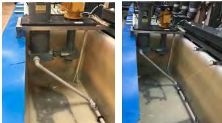
Obr. 5 a 6: Instalace PP čerpadla s filtračním aparátem uvnitř nádrže. Filtrace a cirkulace lázně chemického odmaštění. Linka pokovení elektrických konektorů
