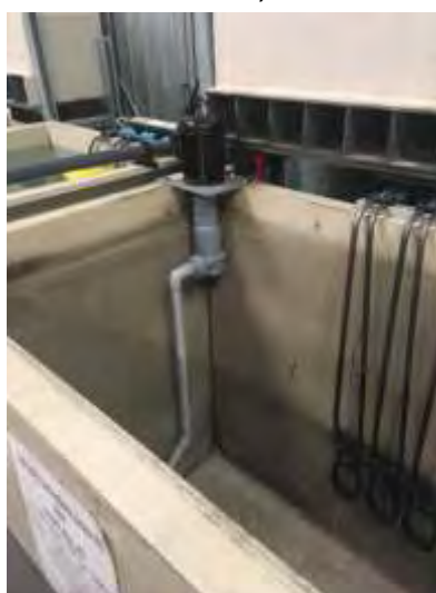
Obr. 7: Instalace PP čerpadla uvnitř nádrže. Cirkulace lázně chemického barvení hliníku. Letecký průmysl
