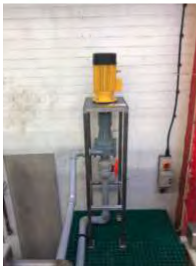
Obr. 8: Instalace PP čerpadla vně nádrže pro cirkulaci lázně moření hliníku. Letecký průmysl
