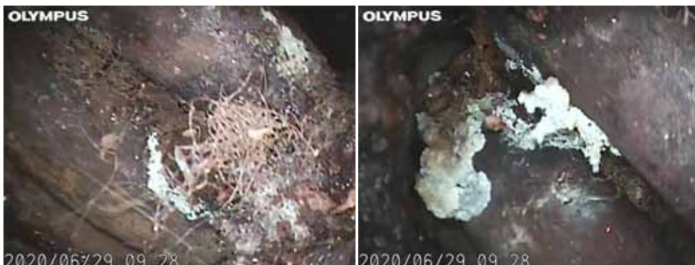
Obr. 5: Ukázka zanesení vnitřní sekundární strany teplosměnné plochy výměníku
