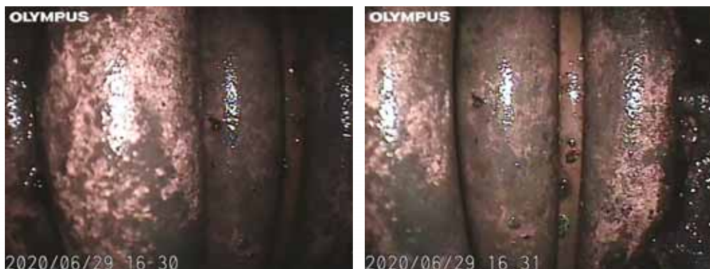
Obr. 7: Ukázka vyčištění vnitřní sekundární strany teplosměnné plochy výměníku
