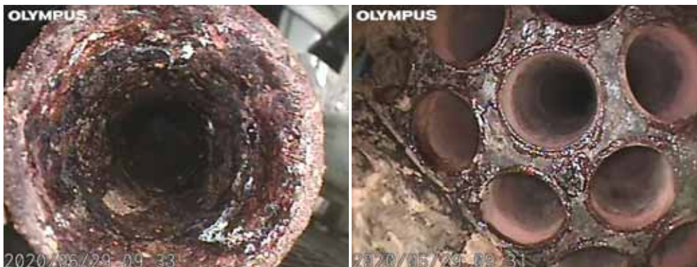
Obr. 4: Ukázka zanesení vnitřní primární strany teplosměnné plochy výměníku
