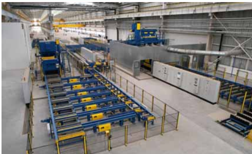
Obr. 2: Zhruba 180 metrů dlouhá dvou-liniová konzervační linka se skládá z linky pro plechy (hlavní linky), do které jsou přiváděny díly z profilové sekce. Kromě toho jsou integrovány rovnací systémy pro plechy a profily, plně automatizovaný lakovací systém a dodatečné tepelné spalování. Všechny systémové komponenty jsou napojeny na nadřazený systém řízení výroby v CMCS. Celý proces probíhá rychlostí posuvu 5 metrů/minutu.
