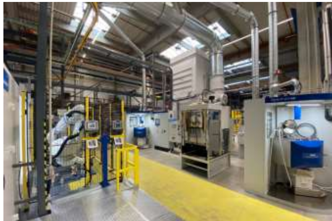
Obr. 4: Celkový pohled na lakovací uzel
