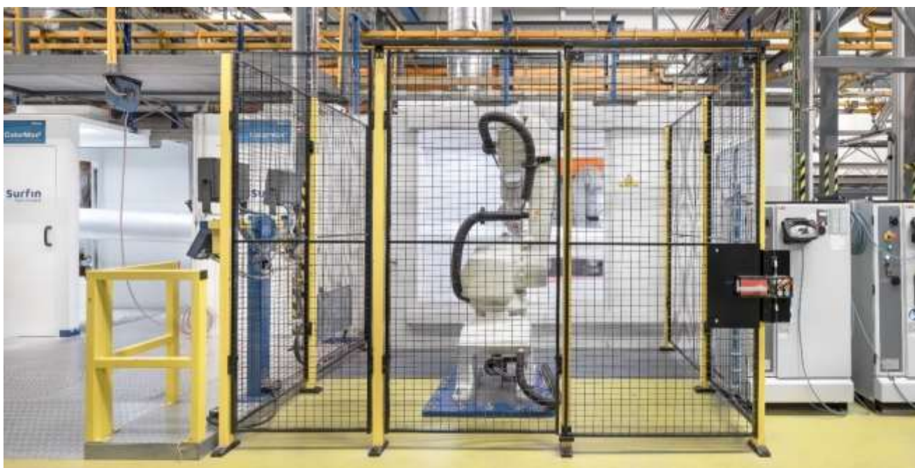
Obr. 5: Bezpečnost robotického pracoviště
