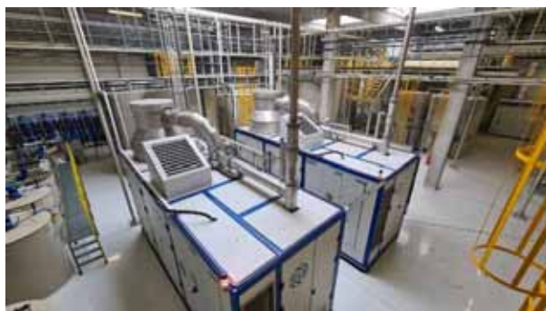
Obr. 8: Čistírna odpadních vod
