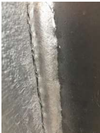
Obr. 3: Extrémní tloušťka povlaku žár. zinku na svaru působí dojem, že se jedná o prasklinu
