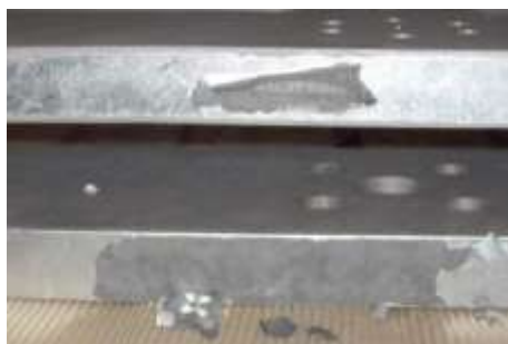
Obr. 10: Delaminace povlaku na termickém řezu
