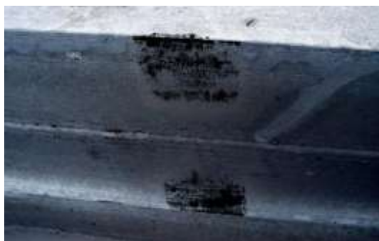
Obr. 30: Poškození od vidlí vysokozdvihu
