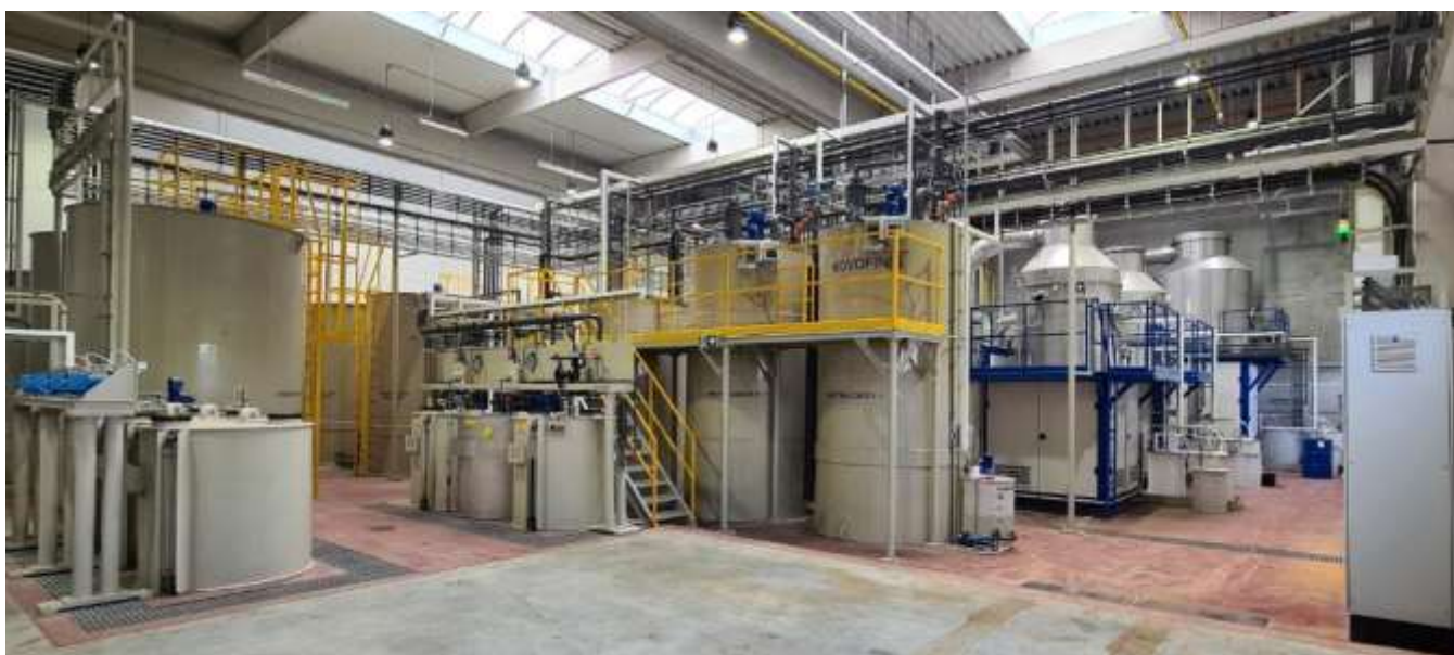
Obr. 3: Celkový pohled na zařízení pro čištění a recyklaci vody
